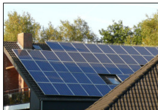
Eine der größeren Photovoltaikanlagen
