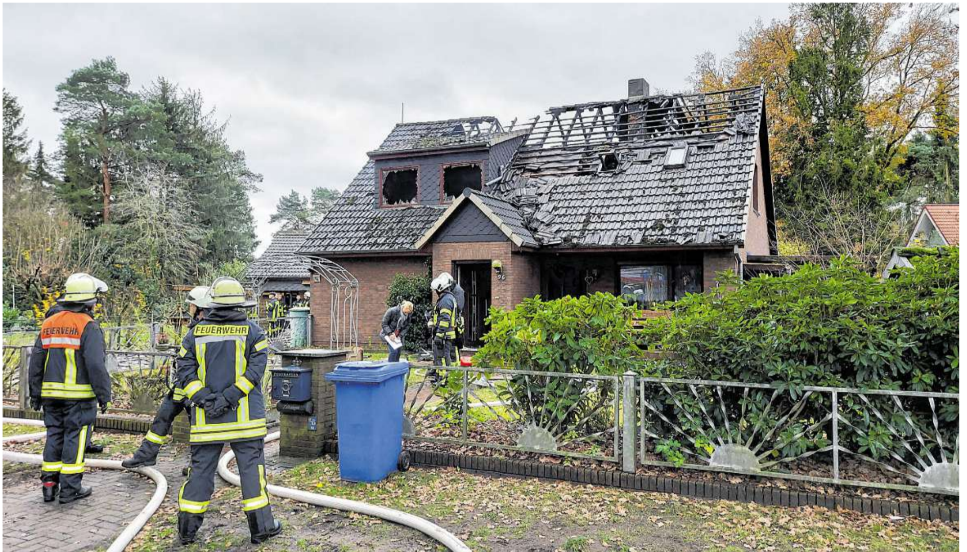
Das Haus in der Schulstraße in Hüttenbusch ist bis auf Weiteres nicht mehr bewohnbar.
