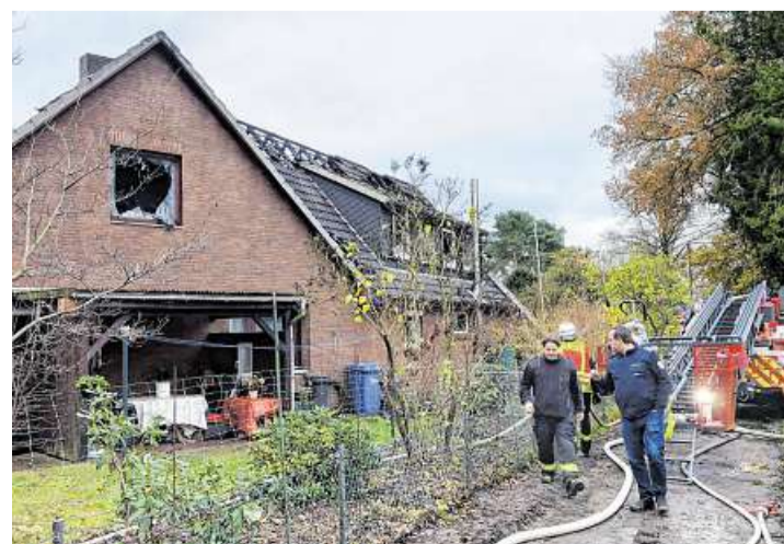
Auch der hintere Teil des Drei-Parteien-Hauses ist von Feuer, Rauch und Löschwasser erheblich in Mitleidenschaft gezogen worden.
